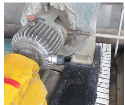
Sensor an der Maschine montiert
